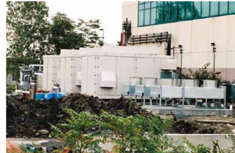
Planta de tratamiento de agua Nueva York (EEUU)
